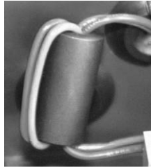
Figura 3-2: Núcleo de ferrita y cableado de alimentación
